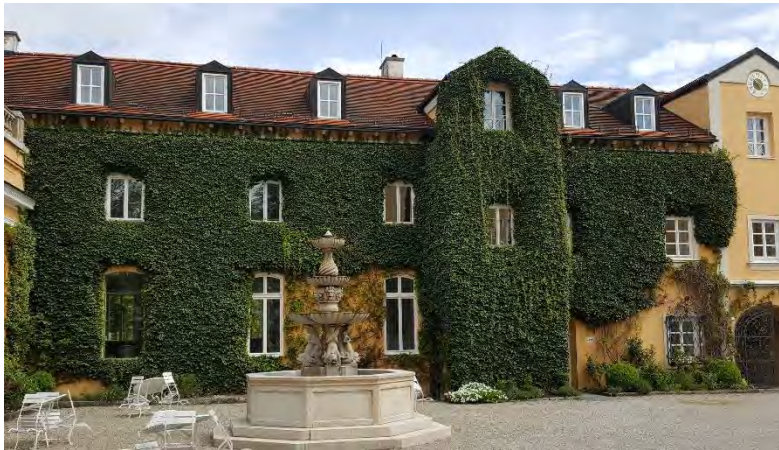
Abb. 19: Kavaliersgebäude mit starkem Efeubewuchs (Eigene Aufnahme)
